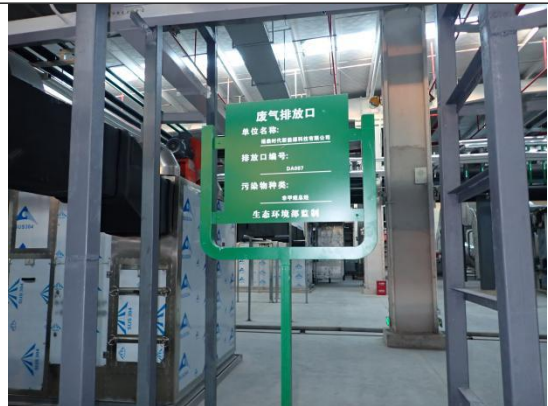
涂布烘干废气处理设施
