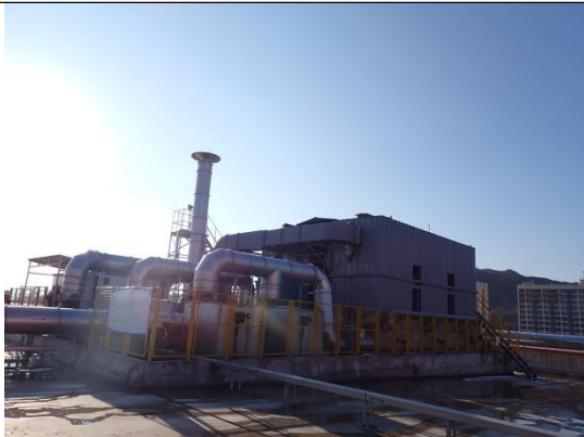
抽真空废气处理设施
