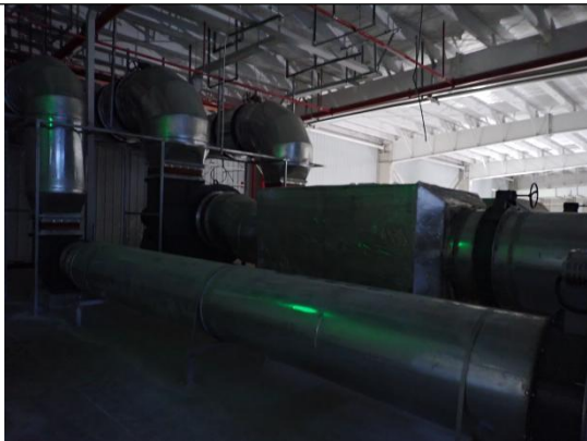
一次注液废气处理设施
