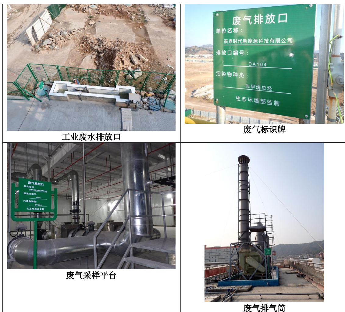
图 4.2-1 废气标识牌、采样平台图
