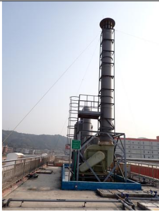
污水处理站废气处理设施
