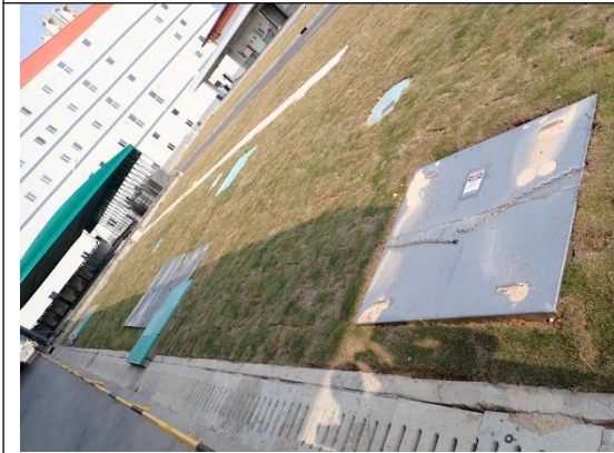
电解液仓外事故池
