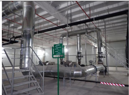
二次注液废气处理设施
